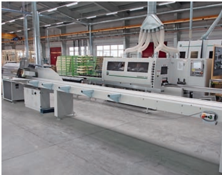
/ Vom Zuschnitt übers Hobeln bis hin zur CNC-Komplettbearbeitung auf einer Conturex 125 (Foto links) setzt Johann Putz auf Weinig-Technologie.
